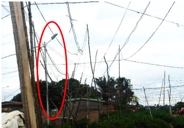
Photo 4 : Une coexistence de poteau électrique et de branchements anarchiques à Odjénékourani (Zone industrielle). Source : Dongo K. Arsène, avril 2017
